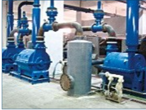
图为清洗装置的抽空泵
